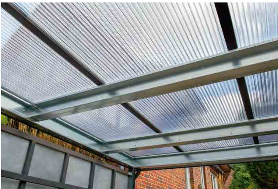
Die stabile Carportüberdachung schützt das Auto und die Wände. Die PC-Stegplatten Marlon Premium Longlife in Glasklar bringen Tageslicht und bieten garantierten Schutz vor Witterungseinflüssen, eingefasst mit Wilkulux-Aluprofilen und dem Regenrinnensystem.
