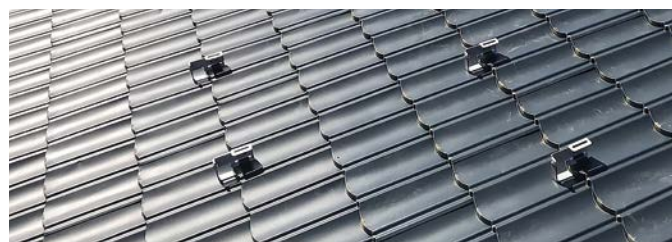
Solarhalter auf Metalldachplatte in Ziegeleindeckung
